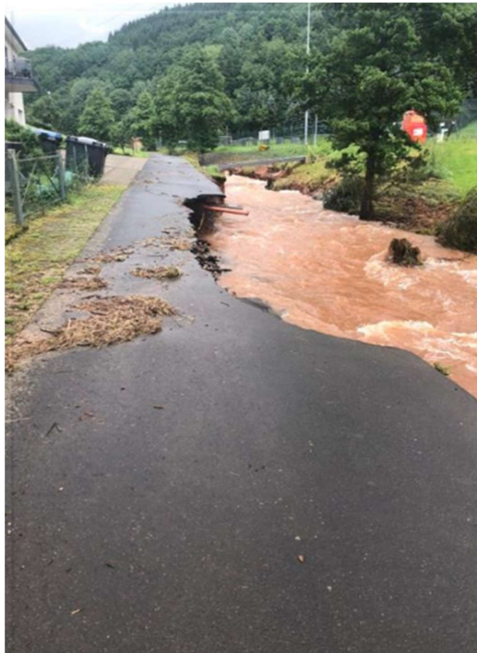
Aufnahme 4: Hochwassersituation Lasel Dürrbachweg Juli 2021 (eigene Aufnahme)
